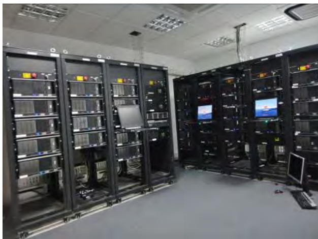
Figura 1 —Sala de equipos.
